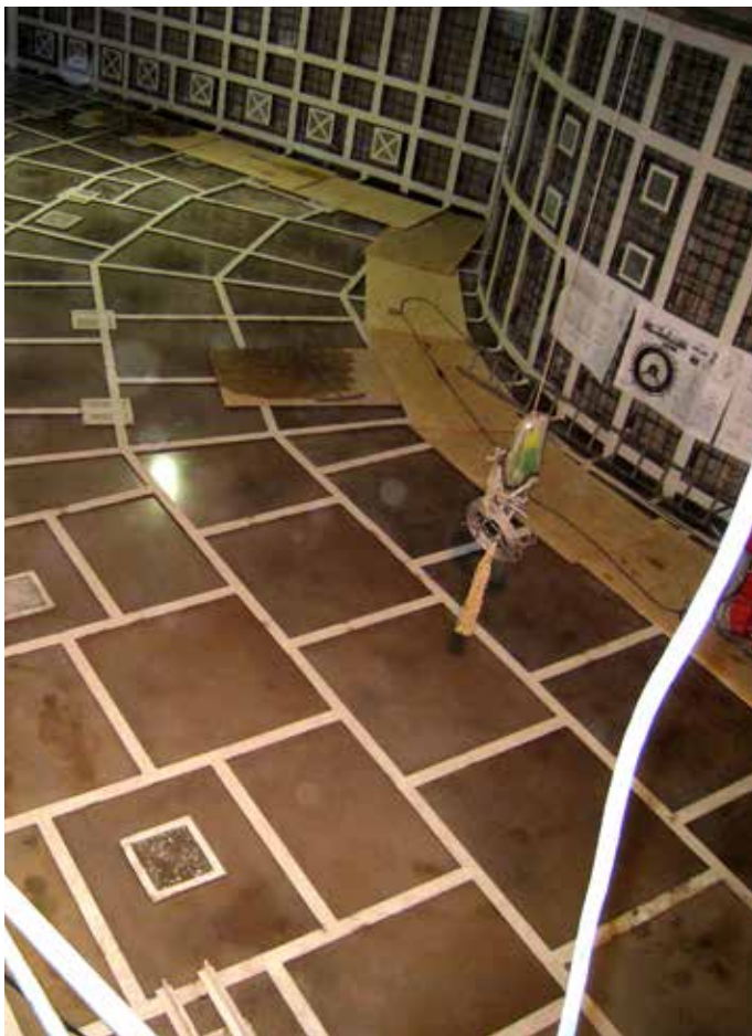
Olkiluoto 3: IRWST Liner
