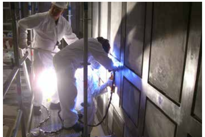
Olkiluoto 3: IRWST Liner
